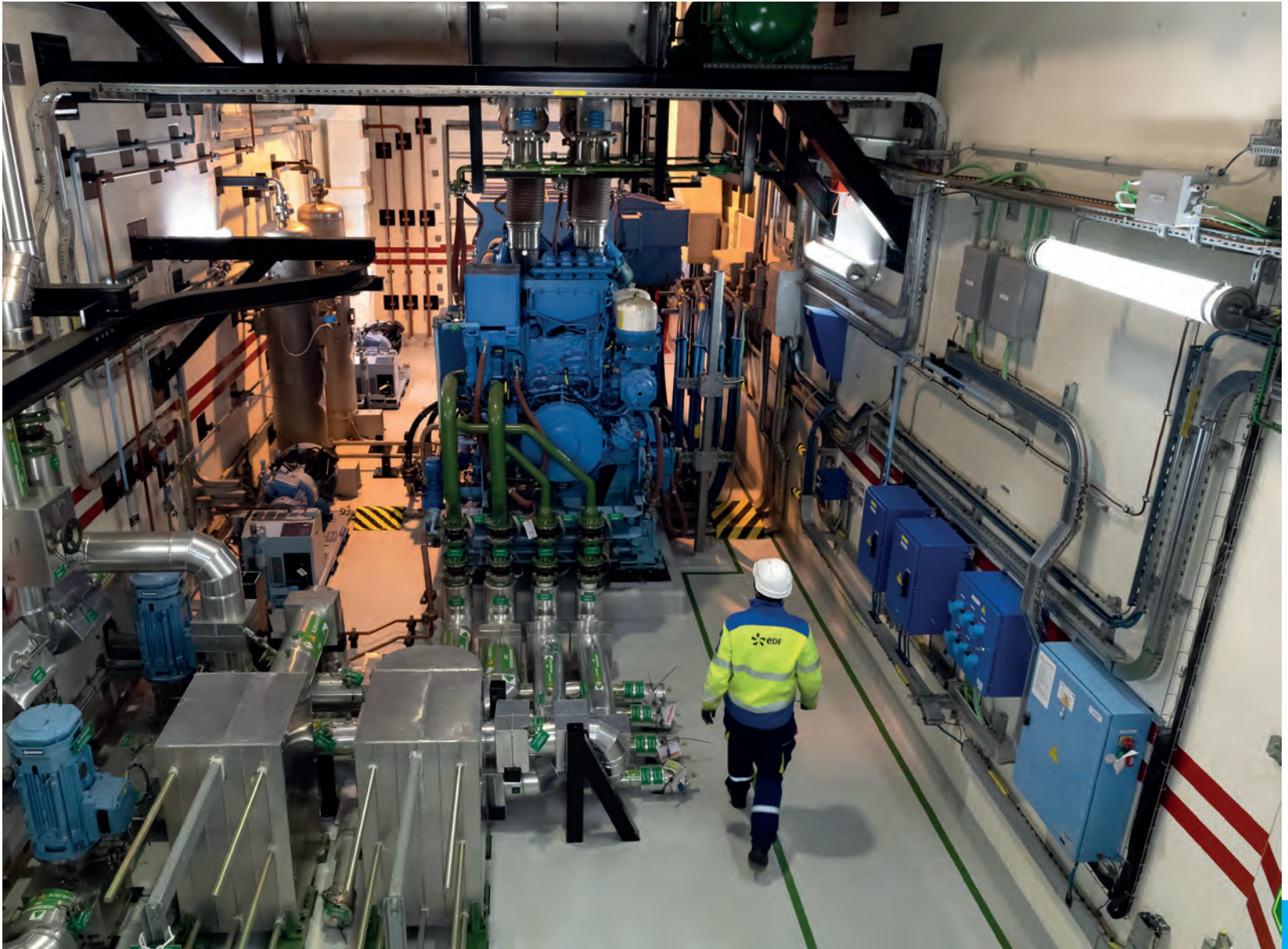
Centrale de Flamanville 3 - Visite terrain diesel source interne électrique
