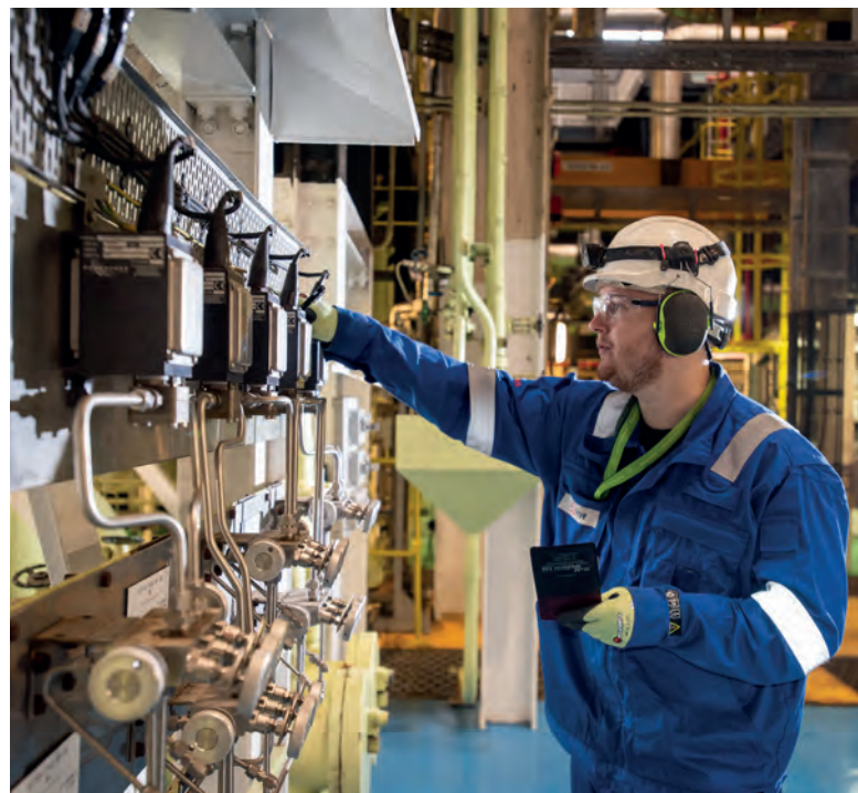
Centrale de Hinkley Point B - Ronde en salle des machines
