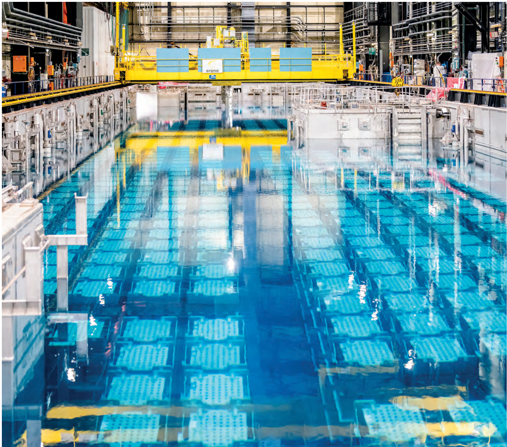
Piscine d'entreposage des combustibles usés. Usine de traitement des combustibles usés Orano, établissement de La Hague.
