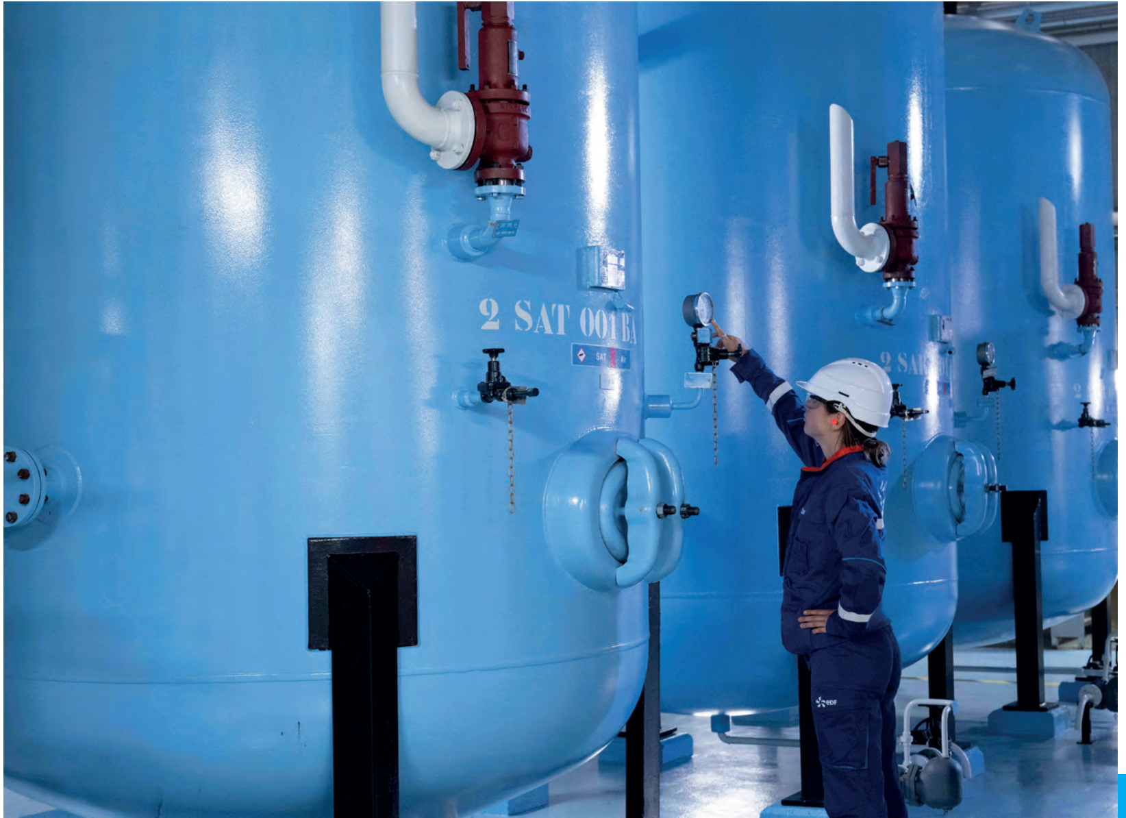
Centrale de Golfech - Surveillance terrain d'équipements de production
